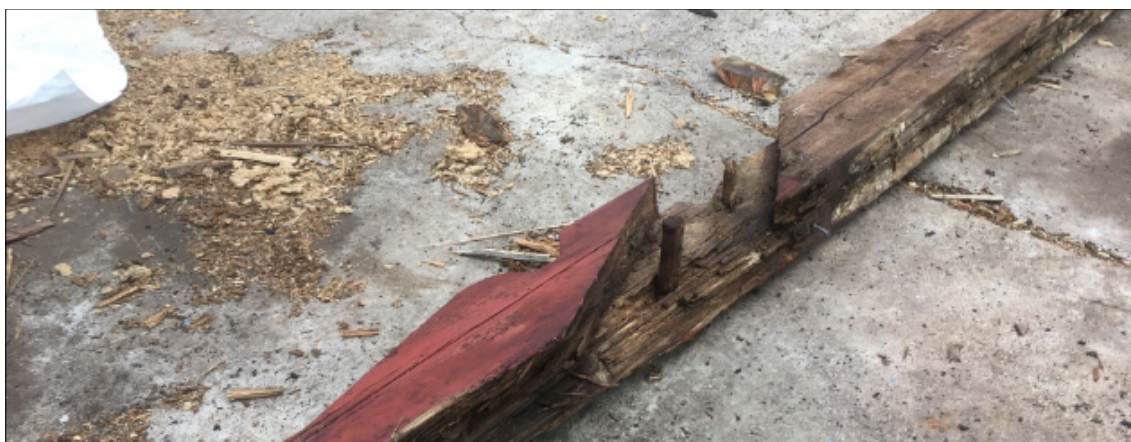
Fig. 7. Takstolarna var dymlade och kopierades. Notera omfattande rötskador som omöjliggjorde återanvändande eller lagning.
