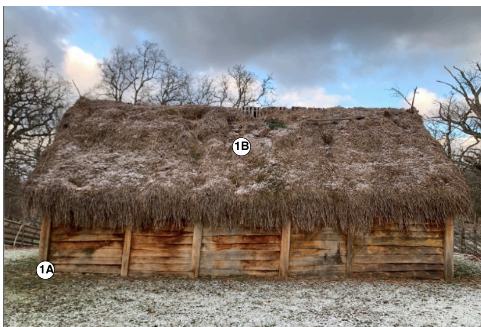
Fig. 9-10. Fähuset från nordöst samt sydväst. Numrering av skadebild enligt texten.
