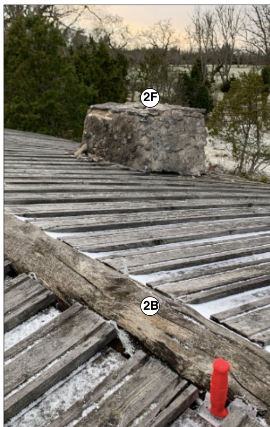
Fig. 13-14. Hela boningshusets takkonstruktion inklusive åsarna kommer behöva bytas ut med tanke på rötskadorna. Spisens genomföringsram mot taket måste också bytas samt översta delarna av mellanväggen som stöder nocksåsen (ovan).
