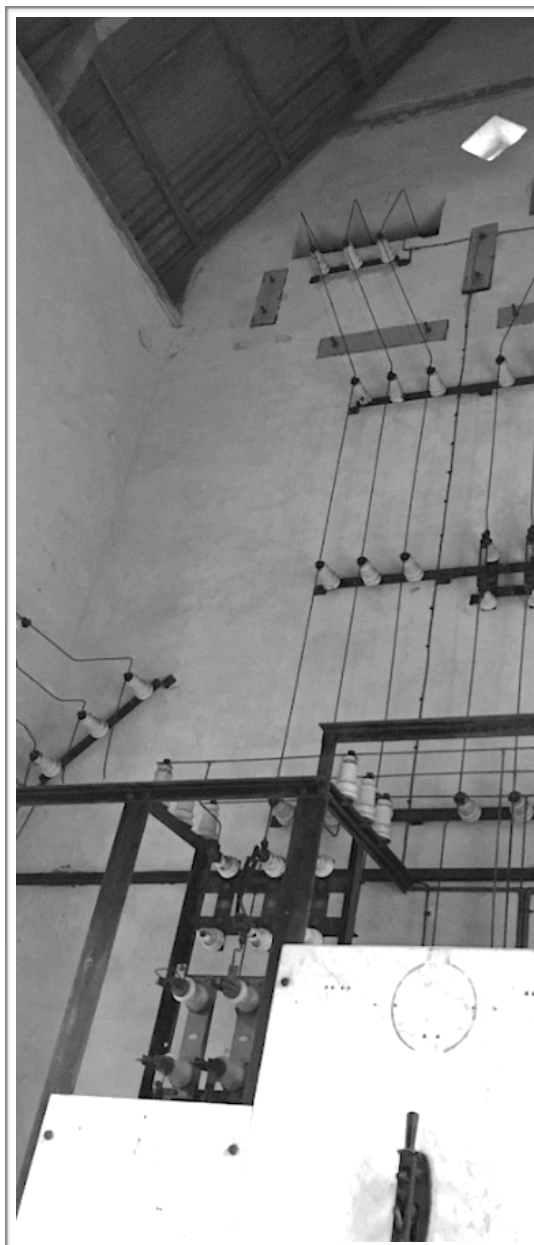
Fig. 11. En del isolatorer samt kablage finns ännu kvar inne i ställverket. Foto upp mot norra takfallet/östra gaveln.
