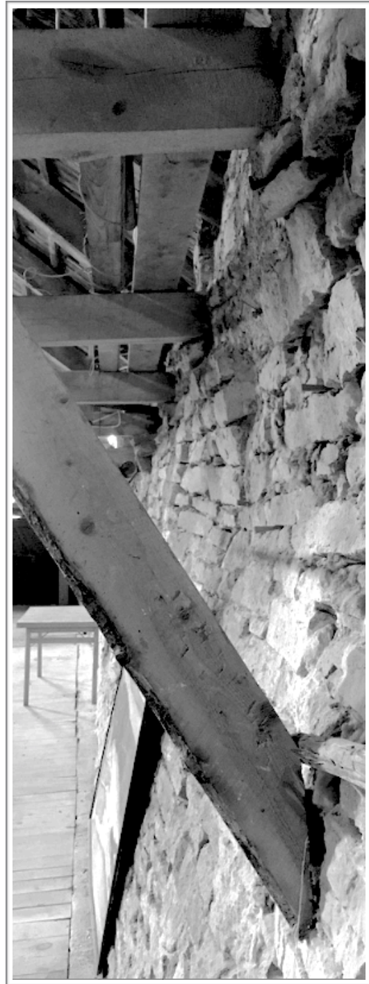
Fig. 38-39. Interiör av kalklada. Ladans västra vägg som är av staplad kalksten har kraftigt kalvat utåt. Orsaken tycks vara borttagna dragband som hindrat takstolarnas tryck mot murlivet. Foton åt söder.
