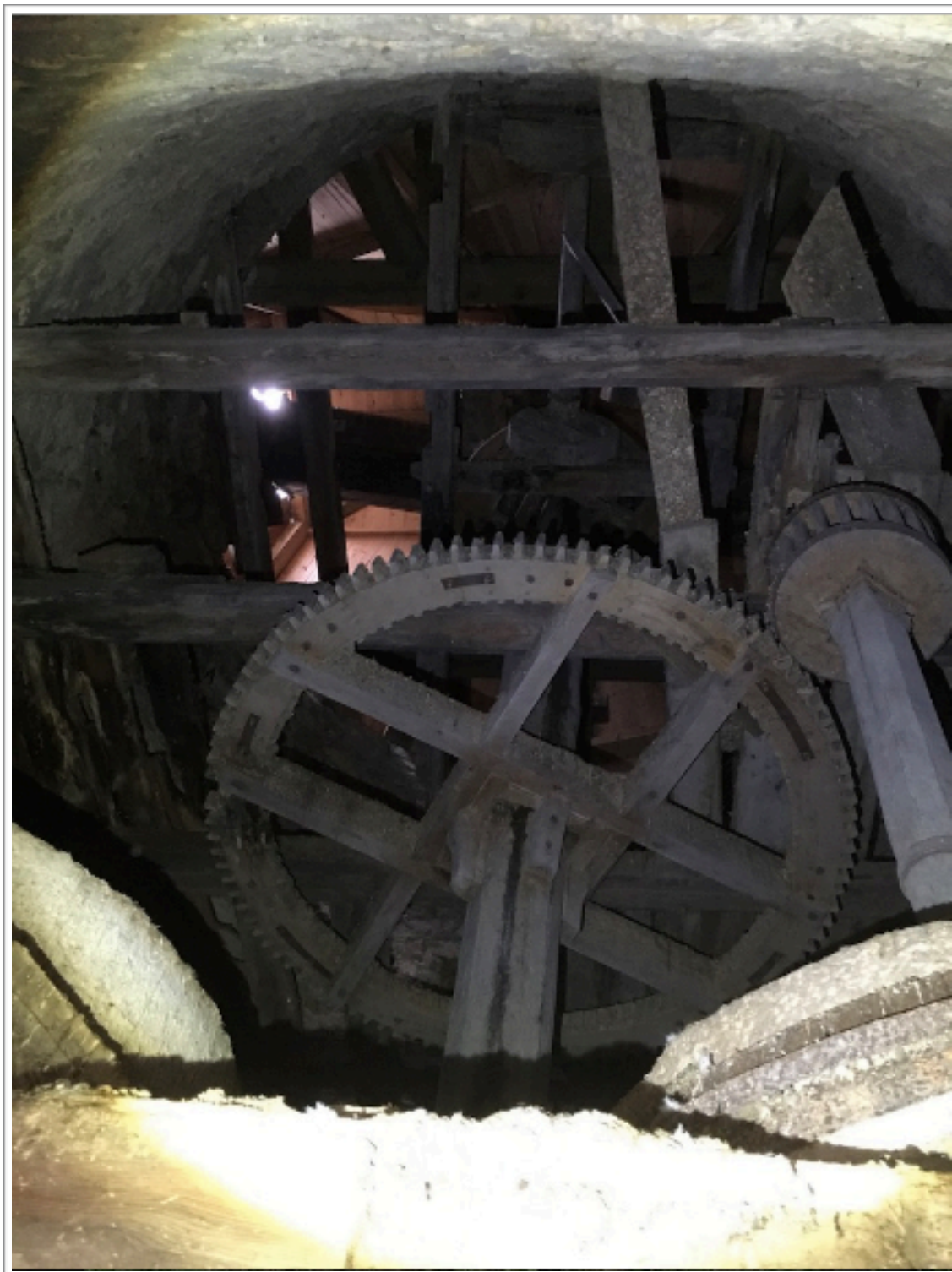
Fig. 20. Hela Lågans insideskonstruktion är mycket illa åtgången med omfattande rötskador. Möjligen kan några delar av kvarnverket räddas. I förgrunden två stenpar samt stjärnhjulet i bakgrunden.
